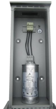
Figura 3. Banco de capacitores fijo
